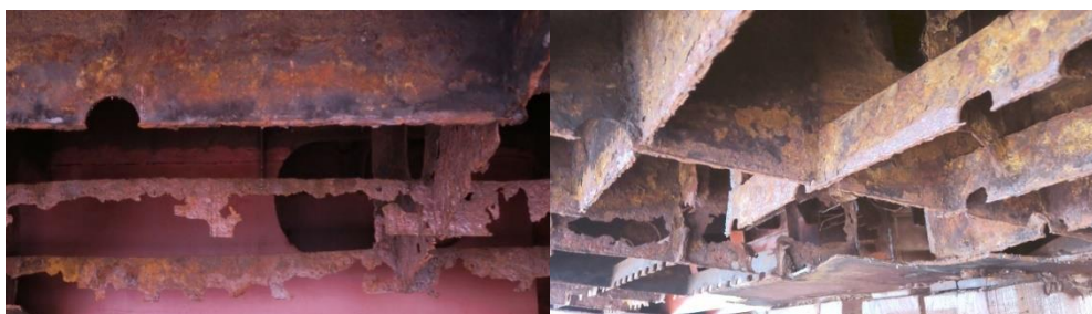
Figura 3.18 Navă cu un grad avansat de coroziune, structura de rezistență fiind grav afectată
