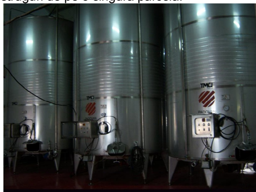
Figura 7.1. Cisterne verticale pentru macerare fermentare
