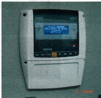
Fig.6.4 Stația de monitorizare XWEB 500
