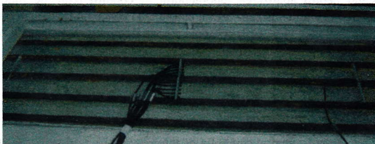
Fig.6.2 Pista patinoarului cu țevi scufundate în apă
