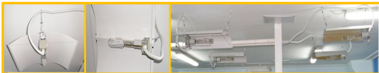
Fig. 2.18. Sistemul de iluminat: 4 lămpi metal - halide (MH) pentru vegetație, tip MAX – LUMENS. (foto. original)
