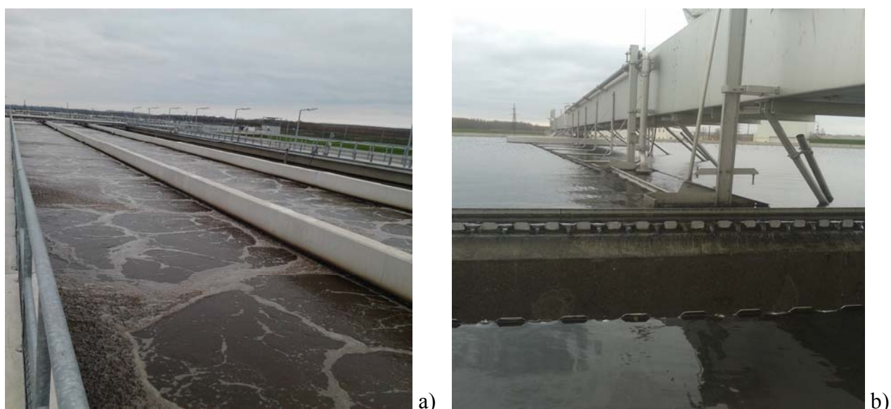
Figura 1.2.2: Imagini din instalația de tratare a apelor uzate din orașul Brăila
